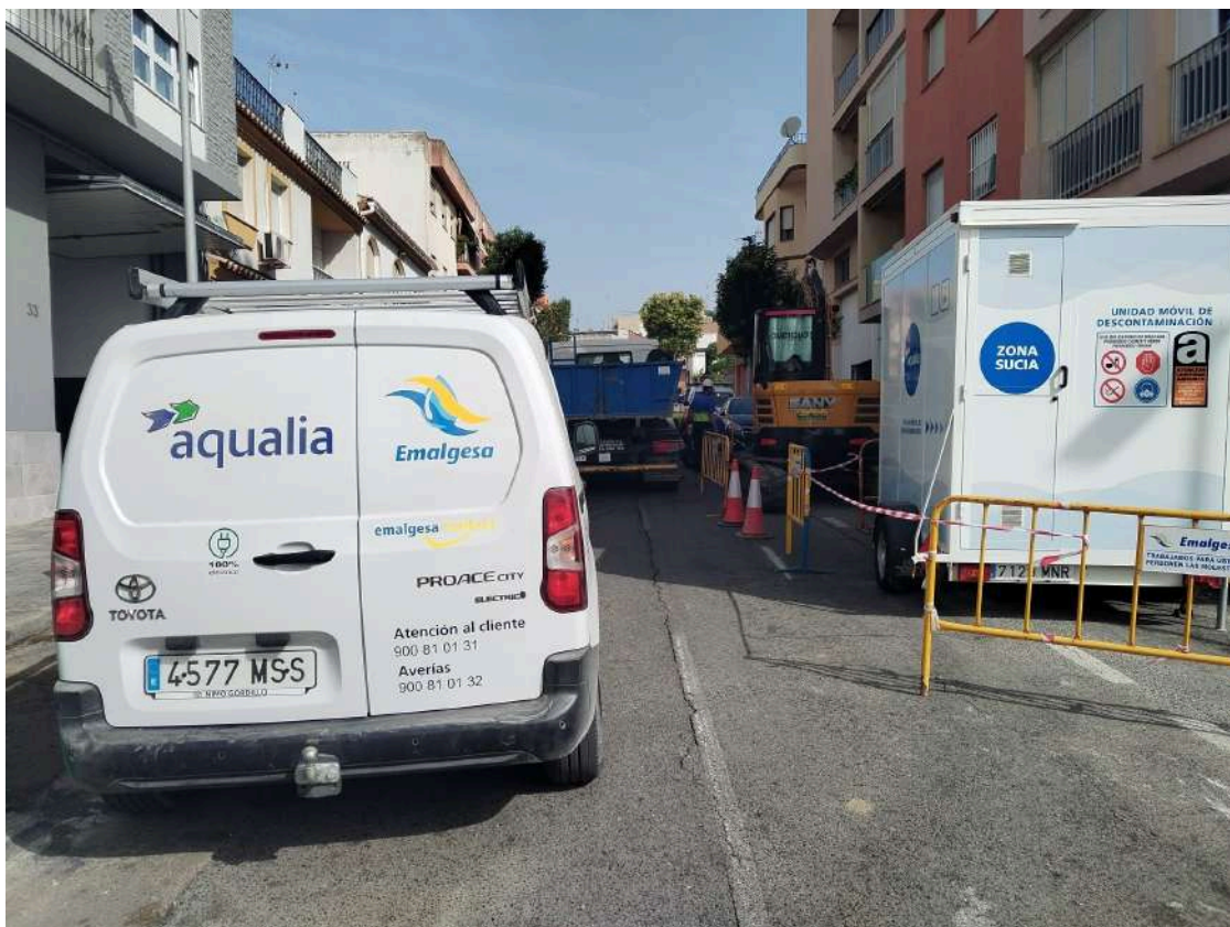
Restablecido el suministro de agua tras la avería en la calle Millán Picazo.
